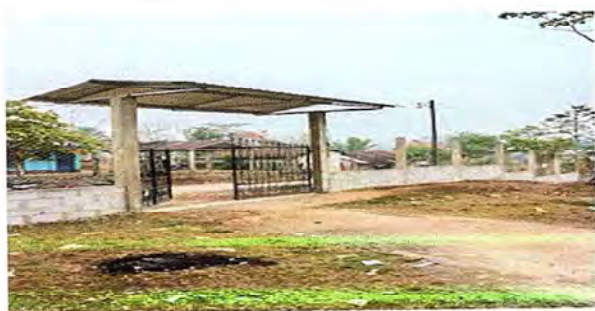
Foto 1: Se observa que la entrada del establecimiento educativo, lado sur, quedó de esta manera.
